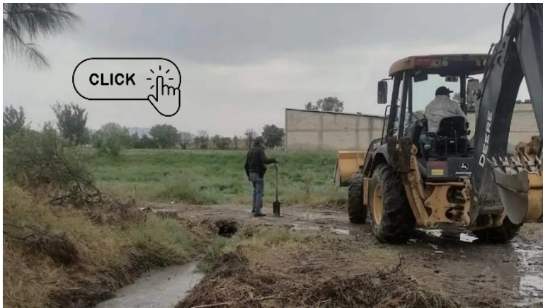
Imagen 89 Desazolver sobre zonas de inundación
