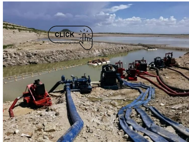
Imagen 88 Bombas Hidráulicas para evitar inundaciones
